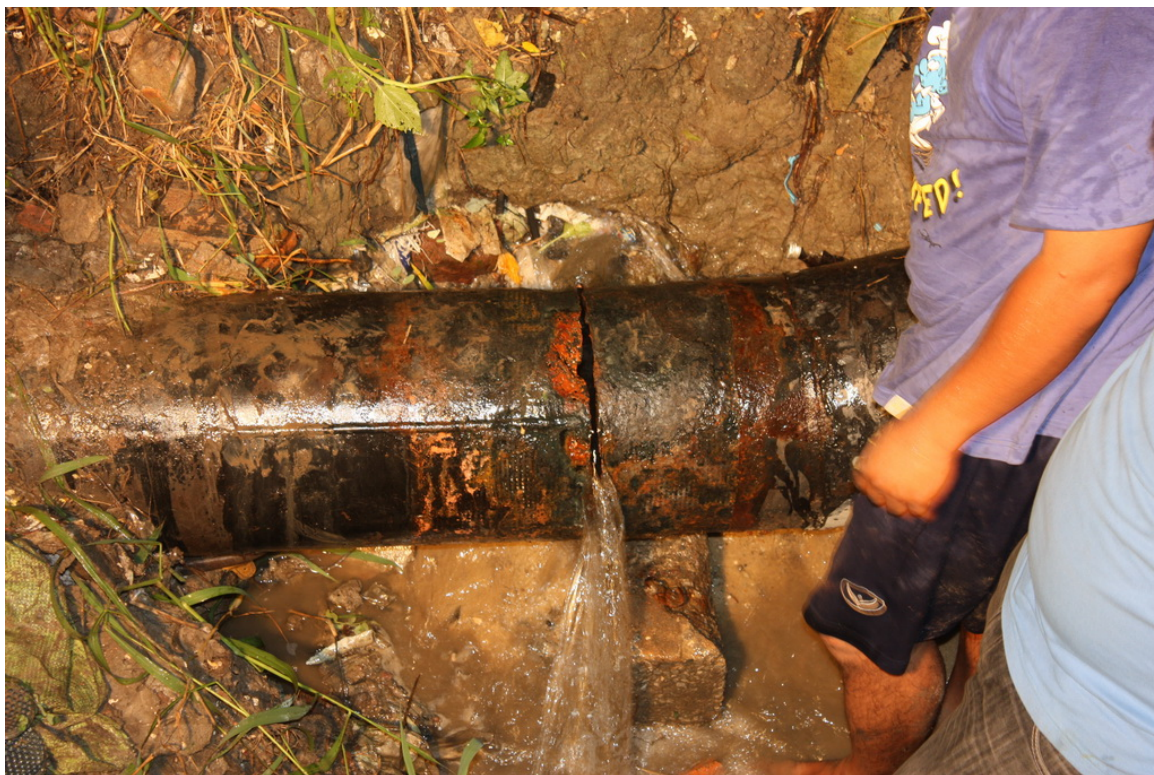
รูป 3-6 ท่อเหล็กเหนียวแตกรั่วจากการทรุดตัวบริเวณคอสะพาน
